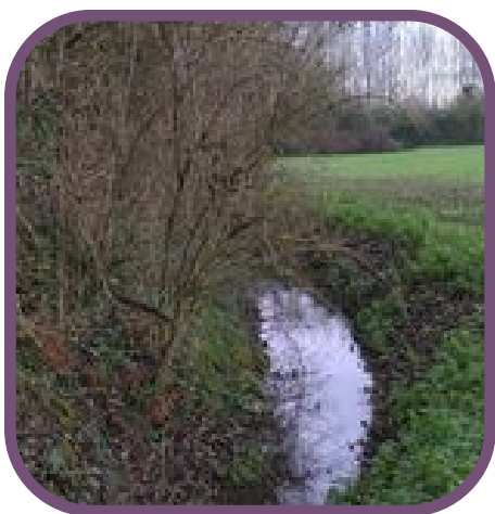
Nettoyage et entretien du fossé au Long Cornet pour assainir le secteur de Sévelingue
